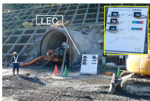
トンネル坑口部のLEC設置状況
