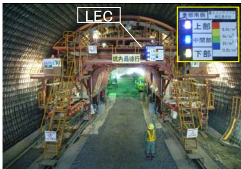
覆工コンクリート用型枠とLEC設置状況 (写真提供 ㈱鴻池組様)
