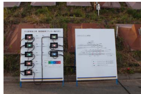
アンカー軸力計へのLEC設置状況
